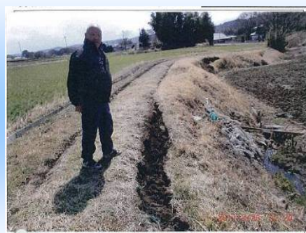
地震による農道法面の崩落
