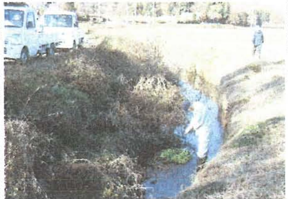
川幅の半分以上に土砂が溜まった排水路(北原地区)
