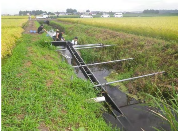
水田魚道「平成26年設置」
